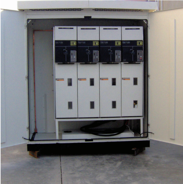
Ring unit inside the Kiosk
